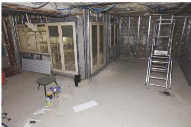
Le rez-de-chaussée du nouveau local accueillera bientôt trois salles de soins, une salle d'attente, un coin brosse et un espace de formation de 50 m 2 .
